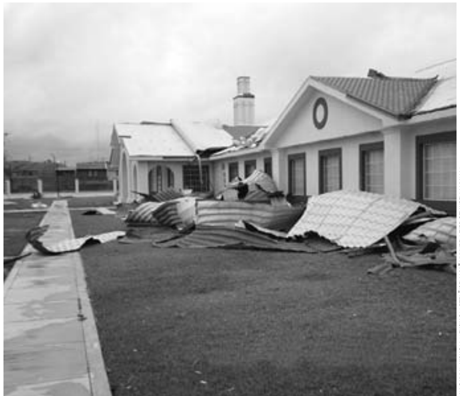
Hurrikaani Wilma vaurioitti pahoin tätä seurakuntakeskusta Cancúnissa Meksikossa.
